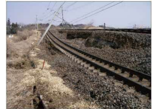
写真1 盛土沈下箇所例
