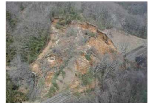
写真2 切土崩壊箇所例
