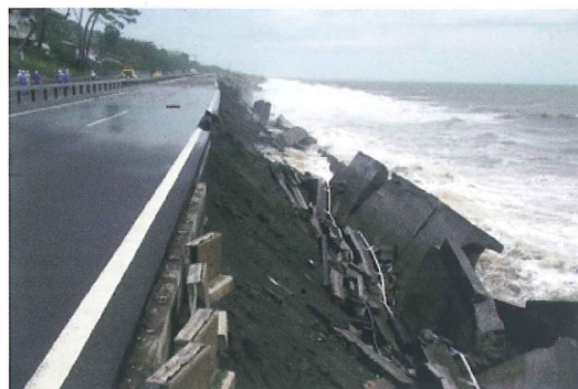
写真-1 被災時の様子 (出典：横浜国道事務所 WEB サイト 4) )
